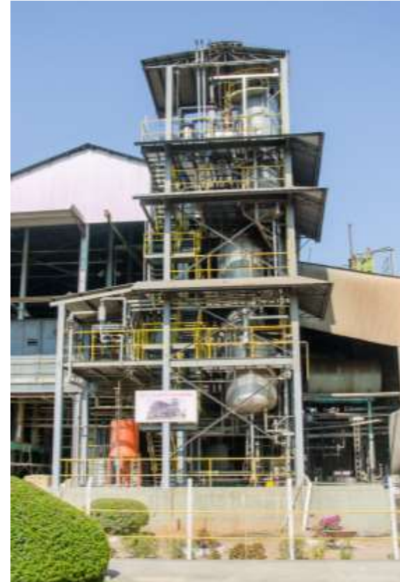
Planta de refinera
